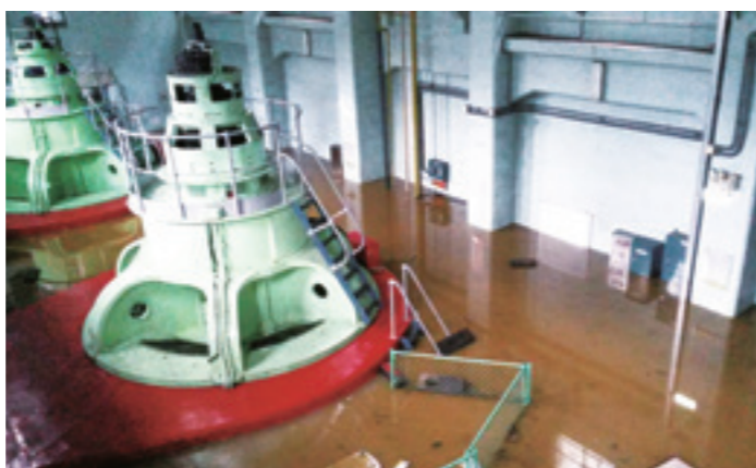
擋住「外水」，卻擋不住「內水」突襲的烏來發電廠，已汪洋一片，須待日後的清理復建。
