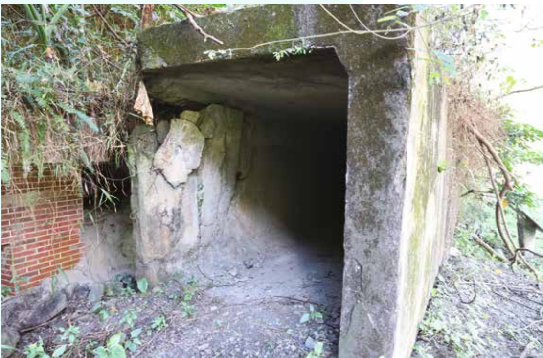
倒塌的水力發電室豎井，可以想像大水的力量有多強。
