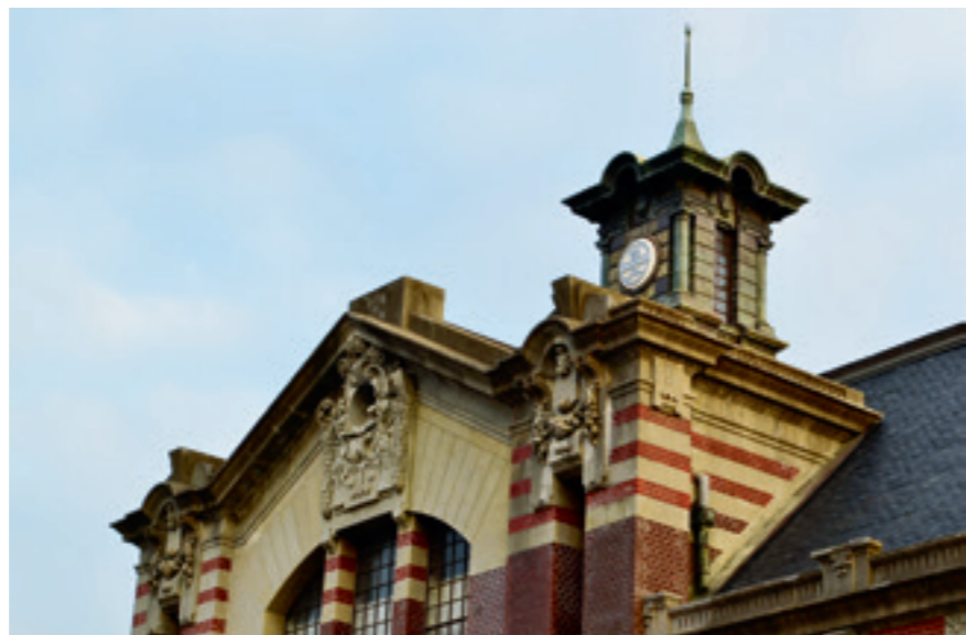
▲ 臺中火車站舊站為後期文藝復興式建築，其建築主體和外牆為紅磚造，有突出屋頂天際線的中央塔樓，十分華麗，凸顯車站建築的特殊與醒目標誌性。
