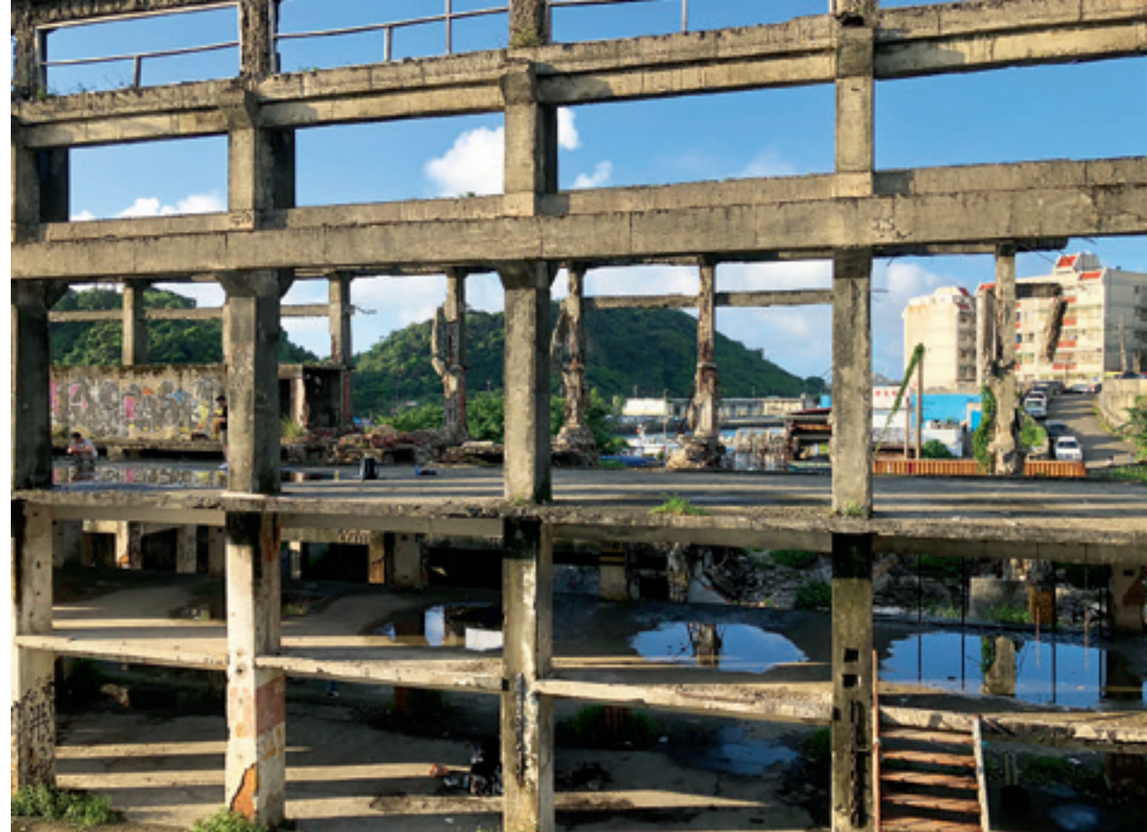
▲ 造船廠僅剩下建築的骨架樑柱，經過不斷的海風侵蝕，呈現出一種歲月滄桑、歷史痕跡的頹敗美感。
