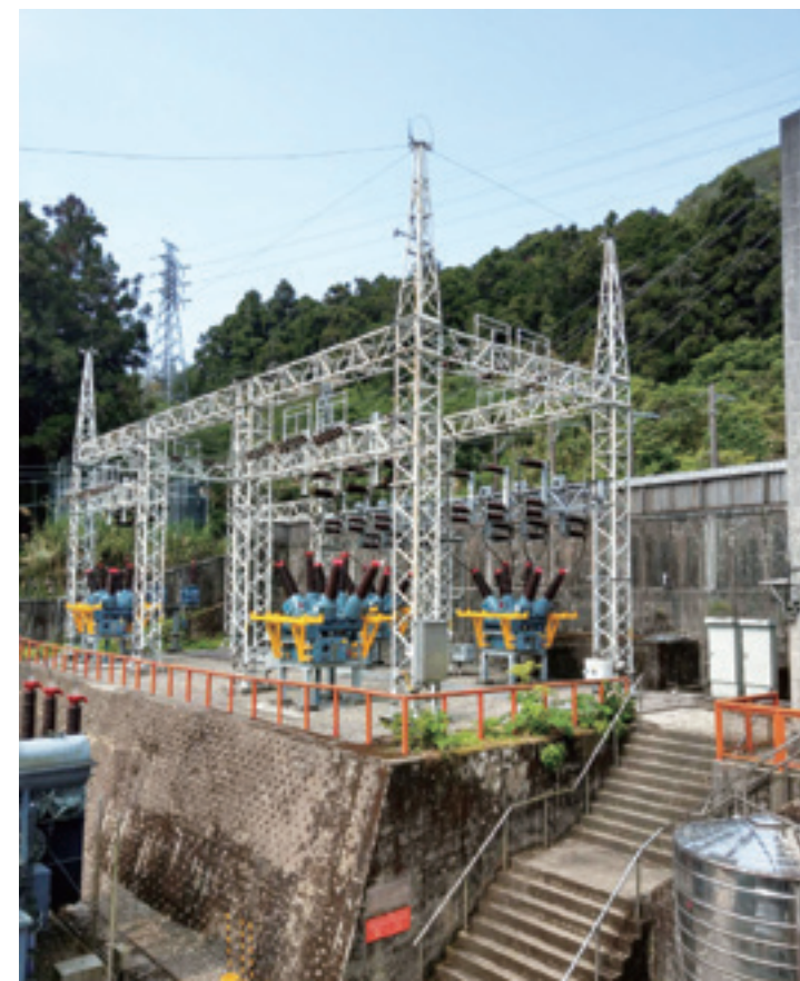
▲ 位於奮起服務所後方的奮起二次變電所，是整個阿里山地區的主要供電中心。（台電嘉義區營業處提供）
