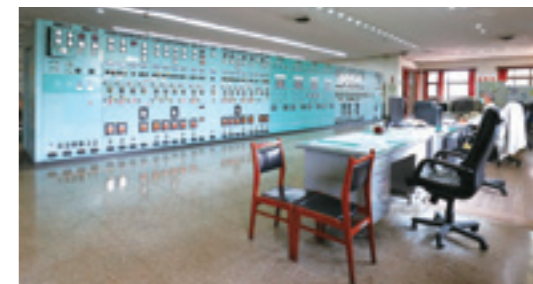
▲ 龍潭超高壓變電所控制室，除了監控本身 345 仟伏設備外，還兼顧竹工超高壓變電所的遠端遙控任務。
