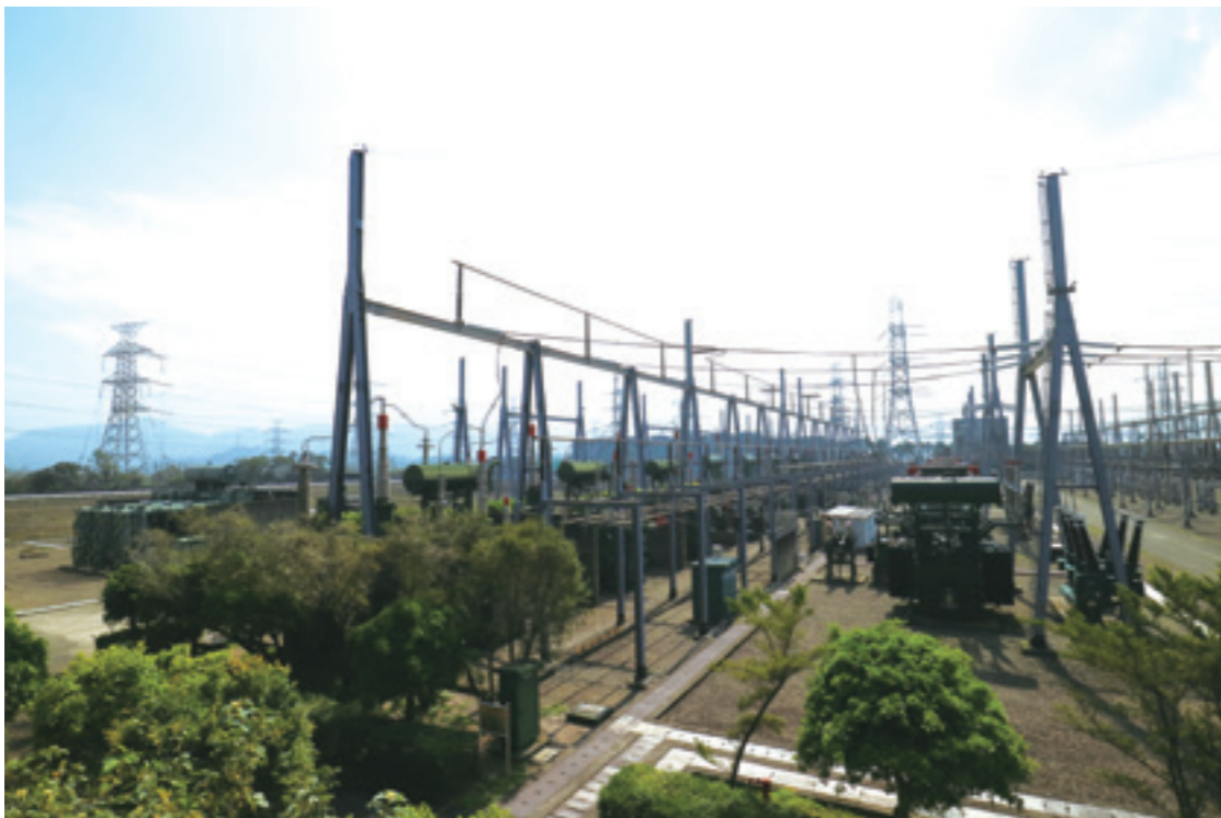
▲ 龍潭超高壓變電所僅存的屋外式 161 仟伏北開關場。
