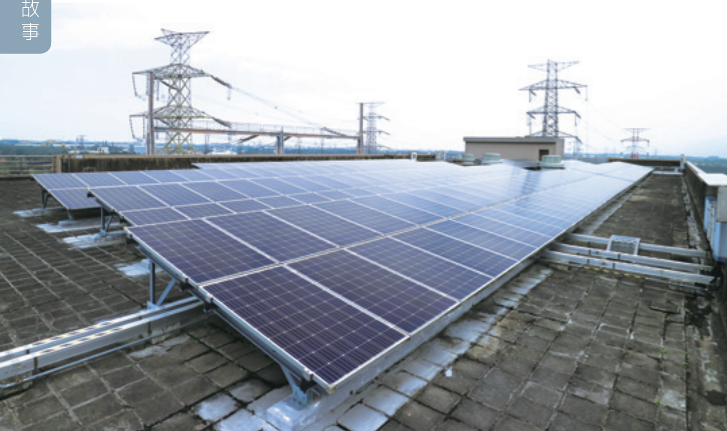
▲ 變電所不只變電，還可以發電。龍潭超高壓變電所南北開關場屋頂均作為太陽能板裝設場域，善加利用空間創造全新產值。
