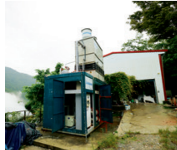
▲ 裝置容量 30KW 的熱發電機組，代表臺灣地熱發電往前邁進的里程碑。
