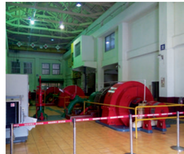
▲ 清水發電廠中三部橫軸佩爾頓水輪發電機，是日治時期花蓮港蓬勃發展與戰後百廢待興的重要功臣。
