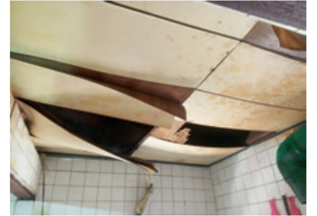
▲ 台電咁仔店志工暑假前夕到周奶奶府上訪視，發現天花板都已崩塌，屋內線路也老舊失修。
