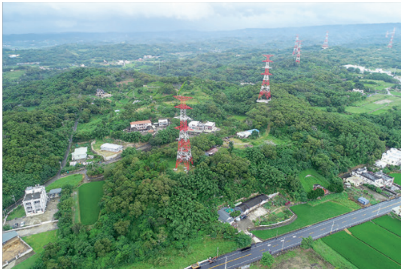
▲ 從高空俯瞰綿延的通霄義和高壓線路。
