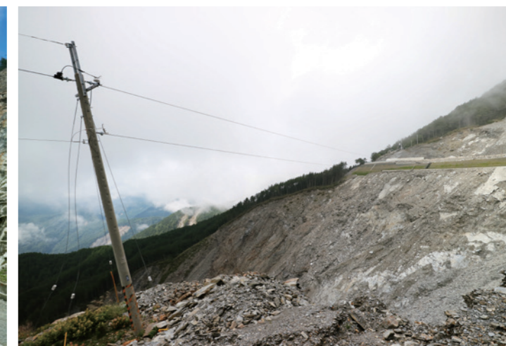
▲ 岌岌可危的利稻分線的 474-1 號電桿，因南橫 148 公里處長期向源侵蝕的崩場，使得原本電桿座落位置已開始滑動，須加速遷移。
