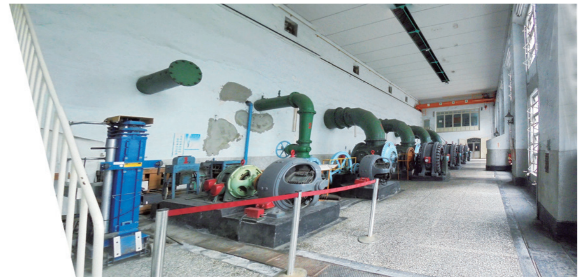
▲ 竹門發電廠的舊發電機組。
