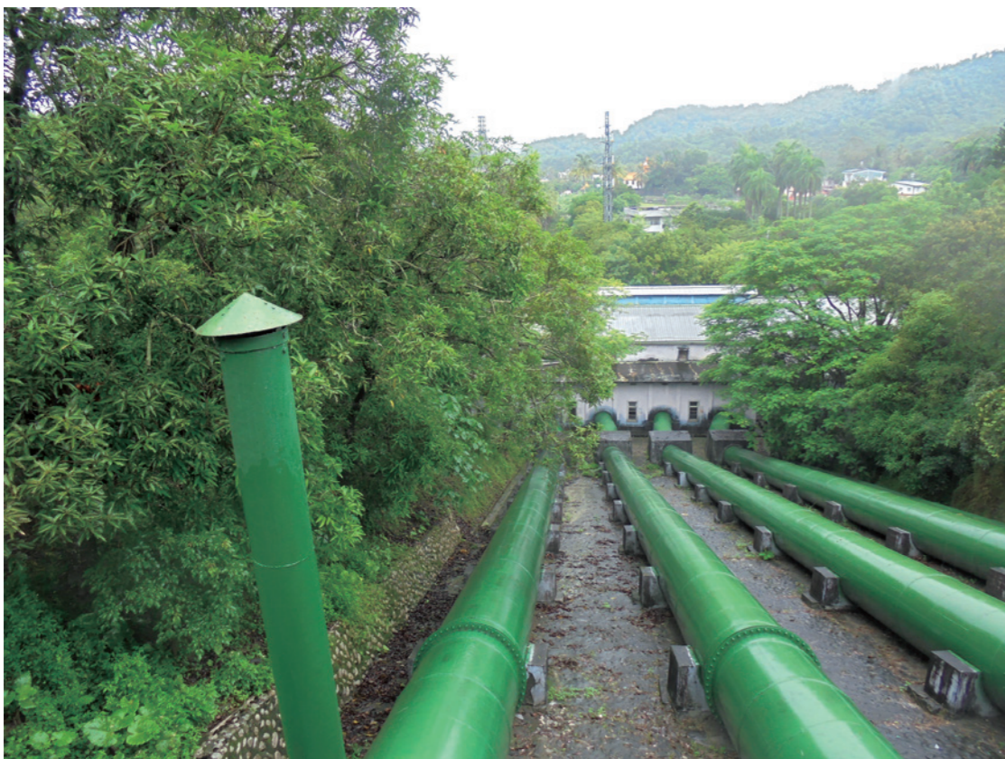
▲ 竹仔門發電廠舊機組的壓力鋼管。
