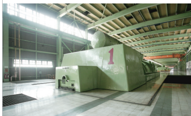
▲ 台中電廠的發電機組。
