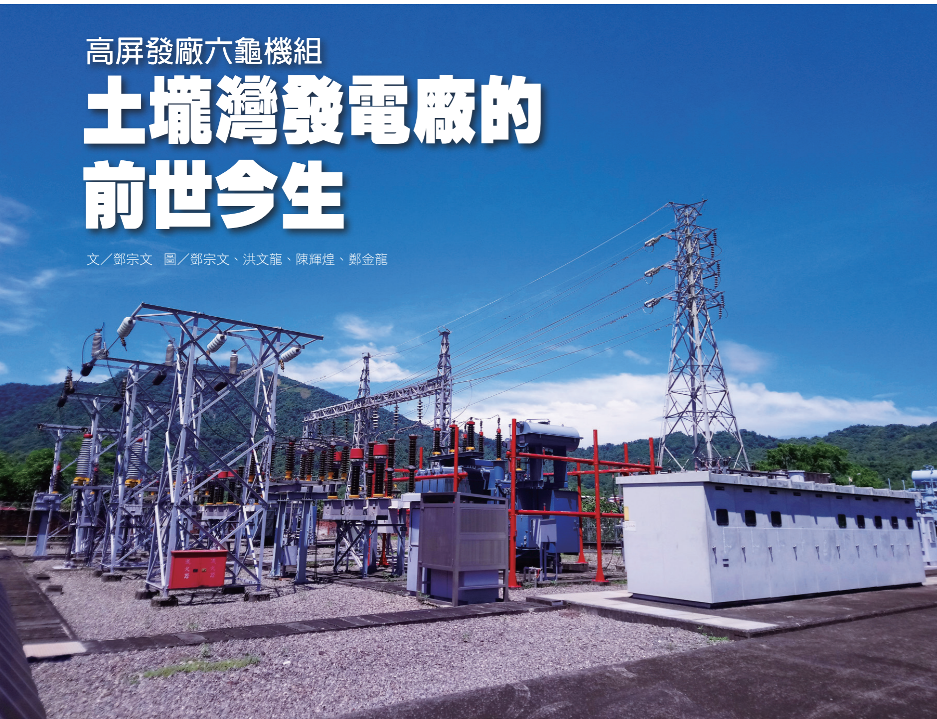
▲ 發電廠機組的開關場，由此開始將電力供應給民眾使用。
