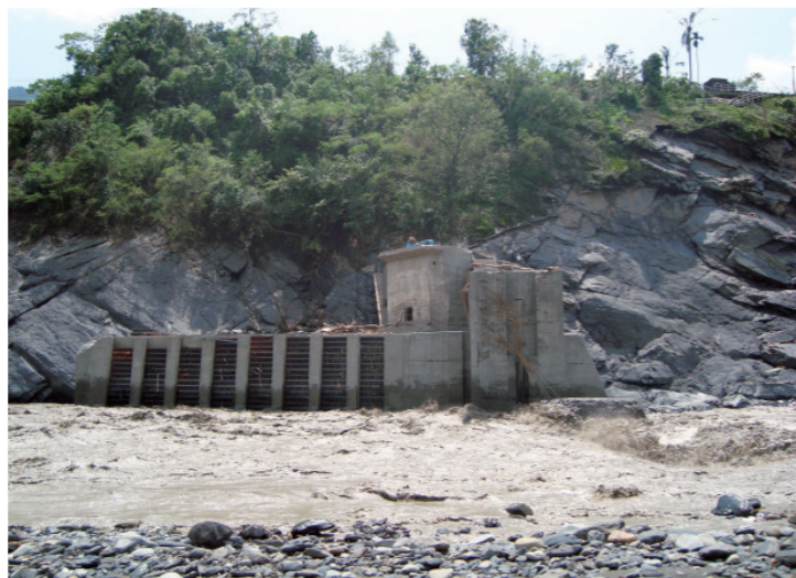
▲ 莫拉克風災後第十天，由巡檢的高屏電廠同仁拍下進水口毀損情形。
