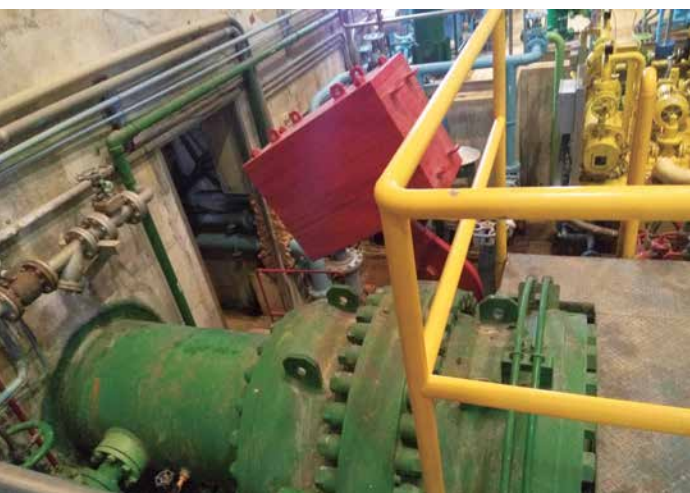
▲ 連接壓力鋼管與水輪機之間的主閘，當機組停機時，照片中紅色的重槌將會放下，此設備十分攸關機組的安全。
