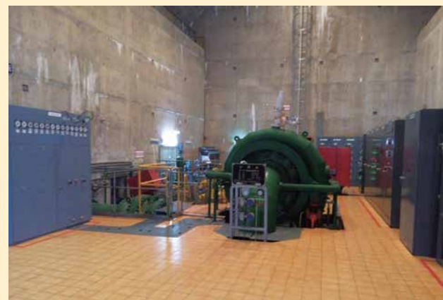
▲ 地下廠房裡運轉中的橫軸法蘭西斯式水輪發電機。
