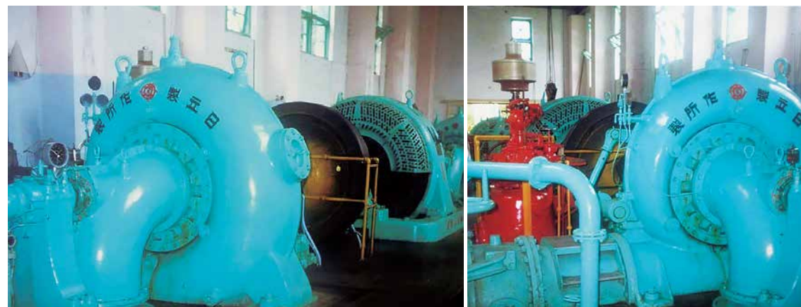
▲ 北山發電廠改建前的發電機組
