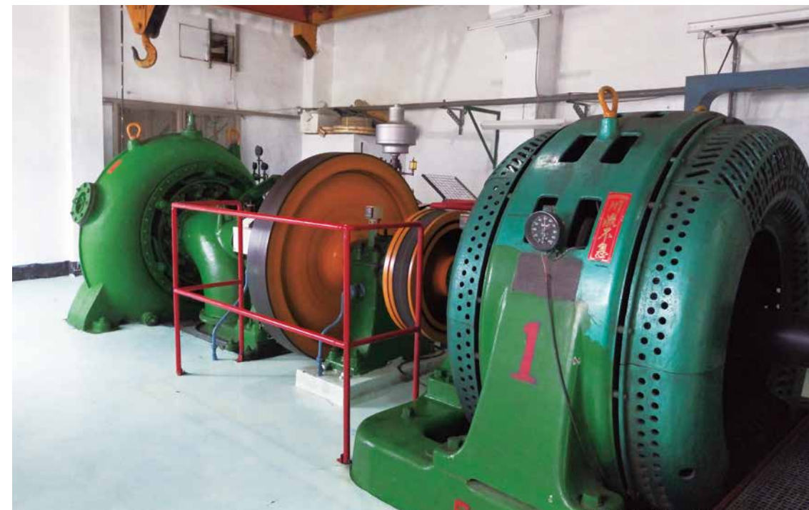
▲ 卑南上圳發電廠 1 號發電機組全貌
