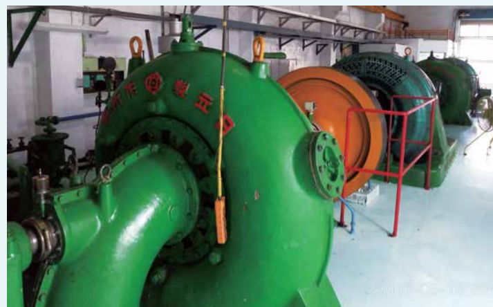
▲ 卑南上圳發電廠水輪機渦殼
