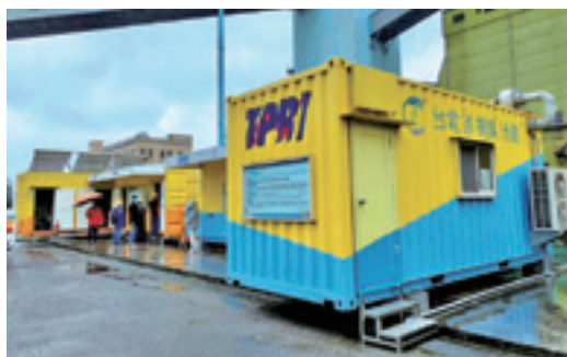
設置於台中發電廠 9 號機旁的碳捕集計畫設備。
