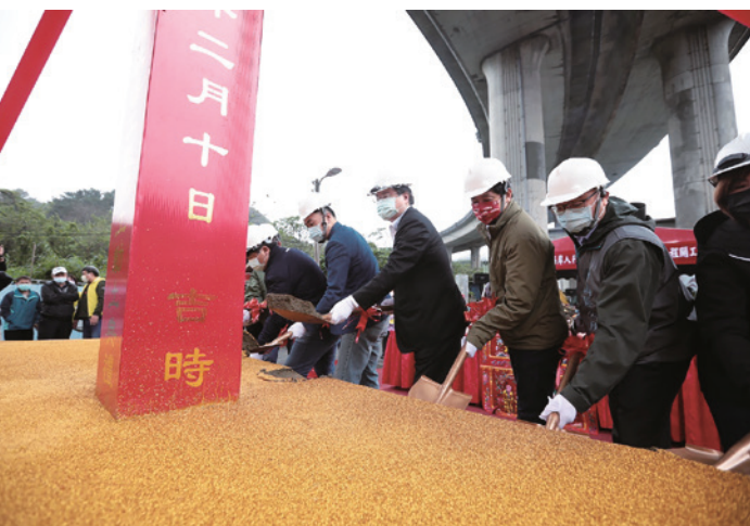
市長林右昌主持「西岸人行路廊景觀空間環境改善工程」開工動土典禮。
