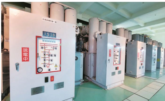
臺灣及澎湖兩端均設有海纜相關機電附屬設備，可偵測海纜外傷、溫度及故障定位。
