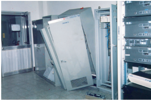
▲ 中寮開閉所控制室內的電氣設備控制箱，經過 921 的震撼後已經歪斜倒地。
