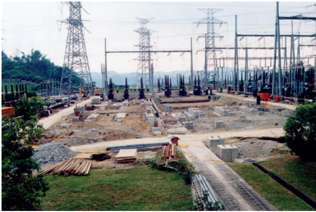
▲ 災後搶修工作中，為防止未來土壤鬆動造成損壞，開關場地基加入連梁工法，讓設備基礎扎實地打入地層中不再受震動位移。
