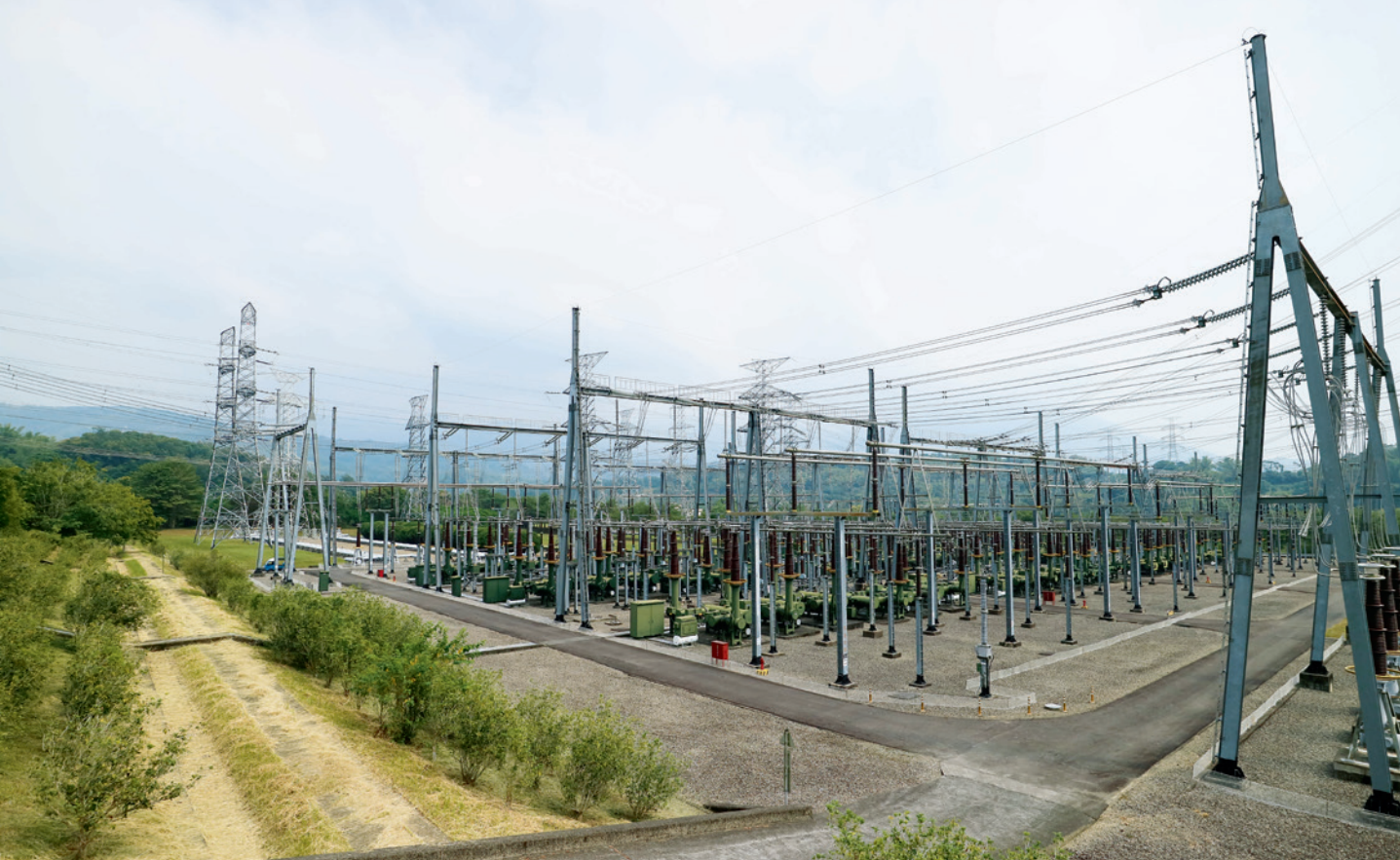
▲ 中寮超高壓開閉所南開關場，為中部最重要電力樞紐。
