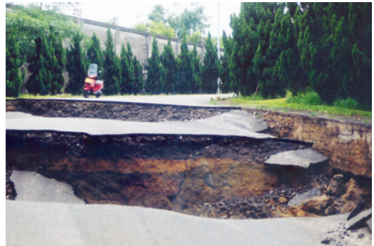
▲ 921 地震後，中寮開閉所前道路完全場陷，對外連結幾乎中斷
