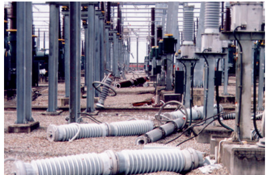
▲ 921 地震中寮開閉所開關場內嚴重受損之情形，造成南電北送完全中斷。
