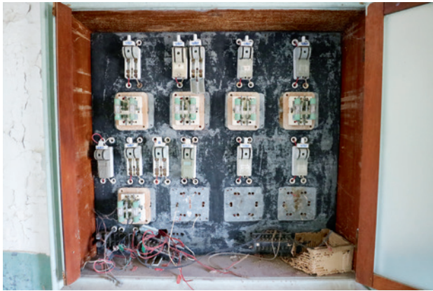
▲ 舊控制室配電盤一隅，從未更動過的配置與早已淘汰的舊式開關，彷彿時間停留在過往時日。
