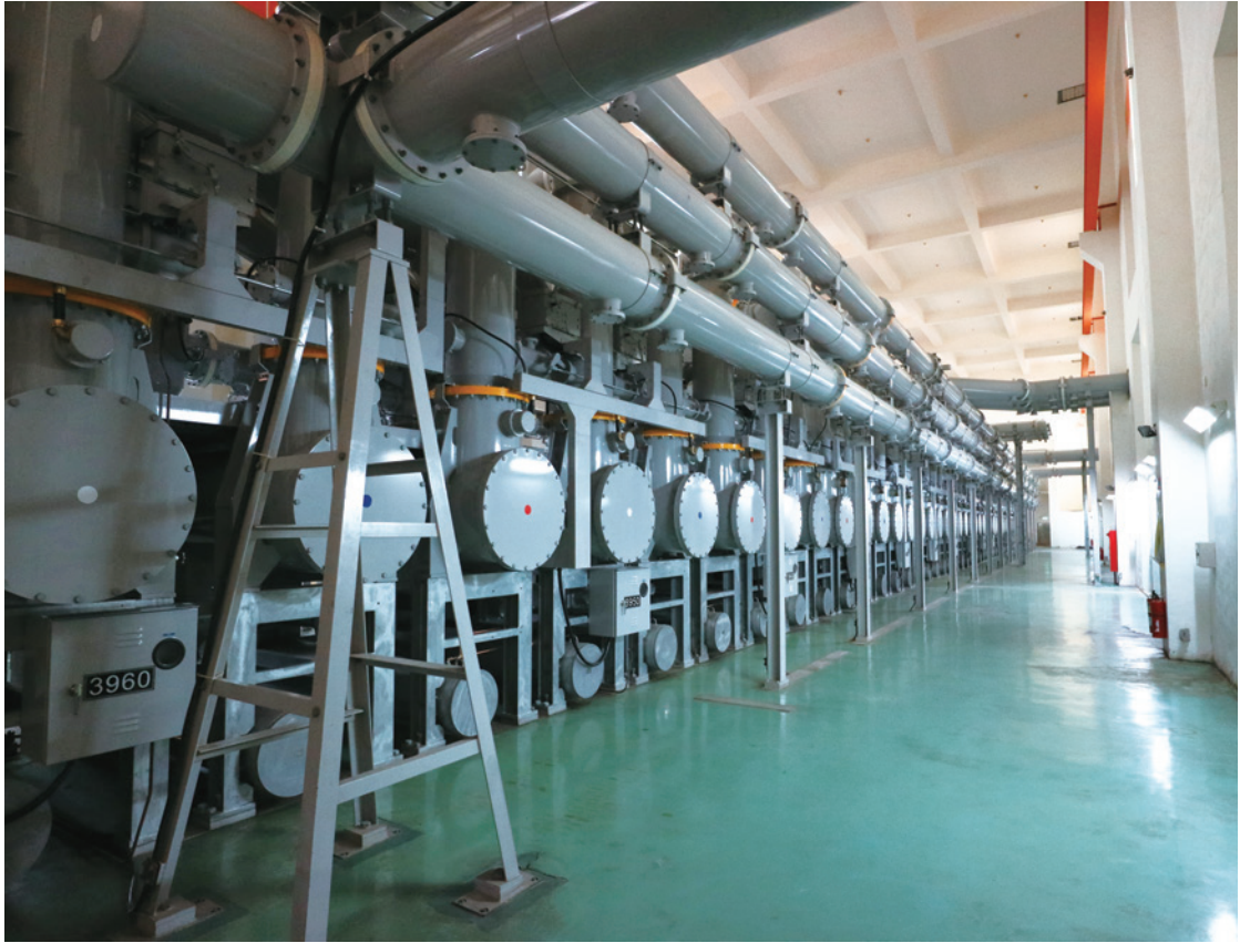
▲ 隱身在建築內的 345 仟伏開關設備，有效防止外部的氣候、污染干擾，減少變電所維護人員的沉重業務。
