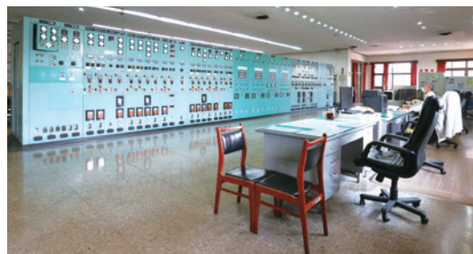
▲ 龍潭超高壓變電所控制室，除了監控本身 345 仟伏設備外，還兼顧竹工超高壓變電所的遠端遙控任務。
