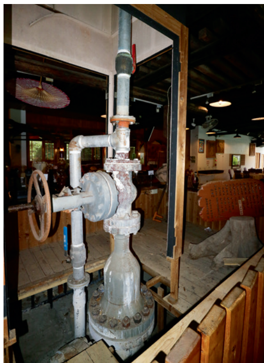
▲ 隱身在屋內的地熱井，雖然經過多年出水量已大不如前，仍具重要的歷史地位。
