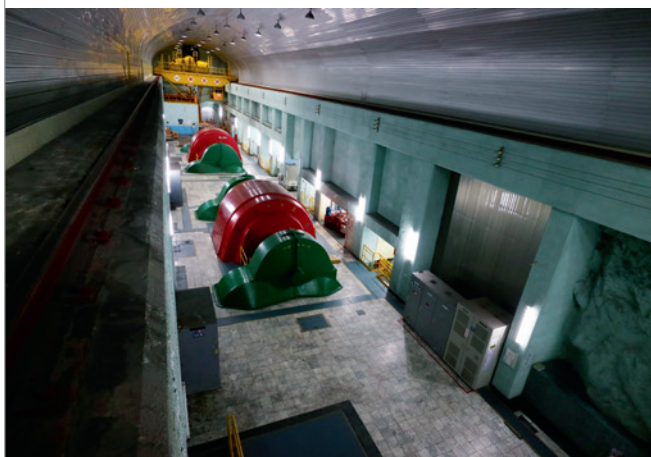
▲ 在山洞中屹立 60 年的龍澗發電廠，是東部最大的水力發電廠。
