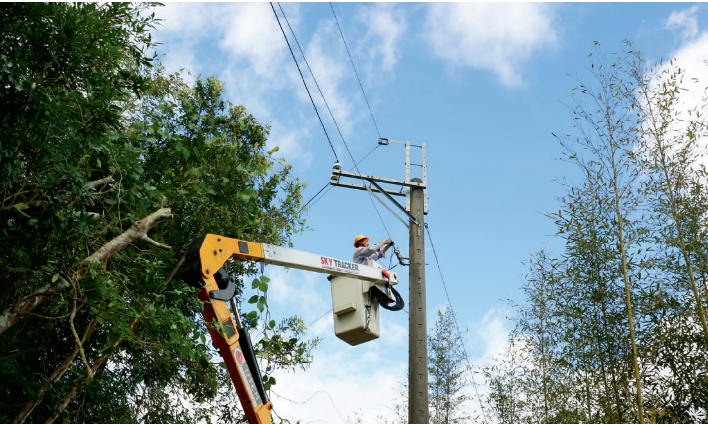
▲ 搭乘升空車進行利稻分線低壓線斷線修復的關山服務所同仁，偏遠山區相對交通與醫療更為不便，因此落實工安意識不僅維護台電形象，更是保護自身性命安全的不二法門。
