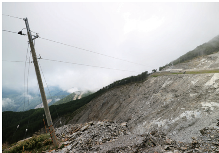
▲ 岌岌可危的利稻分線的 474-1 號電桿，因南橫 148 公里處長期向源侵蝕的崩場，使得原本電桿座落位置已開始滑動，須加速遷移。
