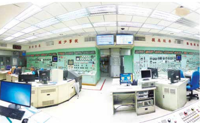
▲ 協和發電廠控制室。
