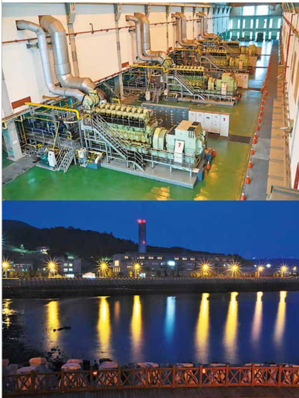
▲ 協和發電廠珠山分廠發電機組及外觀 (林勝裕攝)。
