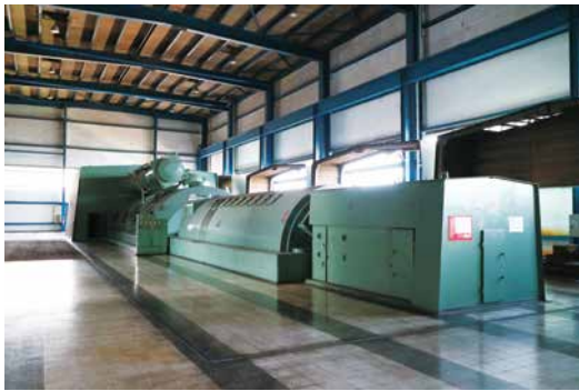
▲ 協和發電廠一號機組 (鄧宗文攝)。
