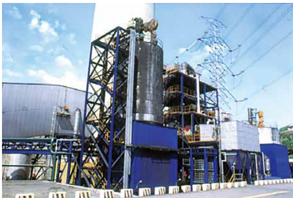
▲ 協和發電廠民國 78 年完成靜電集塵器工程。
